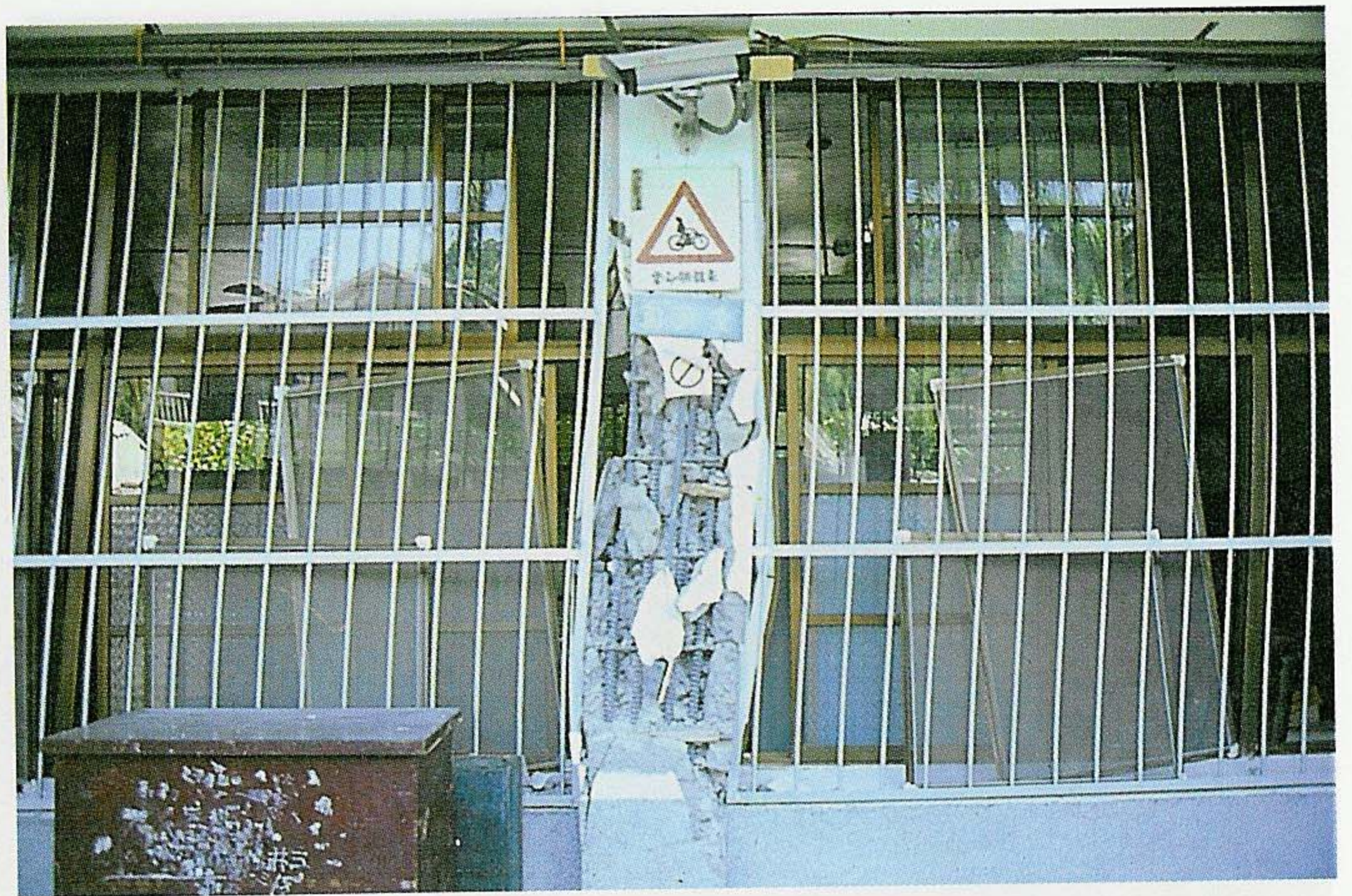
► 圖16 霧峰光復國小：教室為了採光經常將兩側的牆面設計有大面積的窗戶，經常造成校舍的結構不良，教室的所有樑柱均彎曲破壞。
