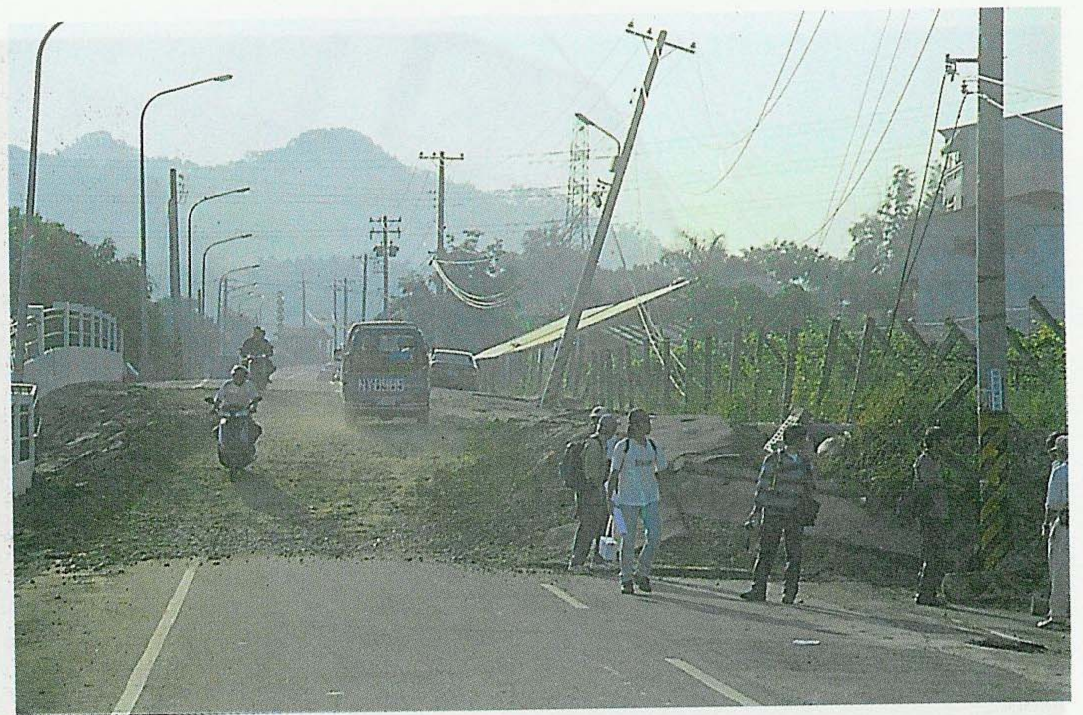
► 圖18 北溝溪：斷層橫切道路將東側的路面抬升1.5公尺，原來是呈水平的路面，現在車輛經過時必須上一個坡道。這個斜坡就是斷層形成的斷層崖。
