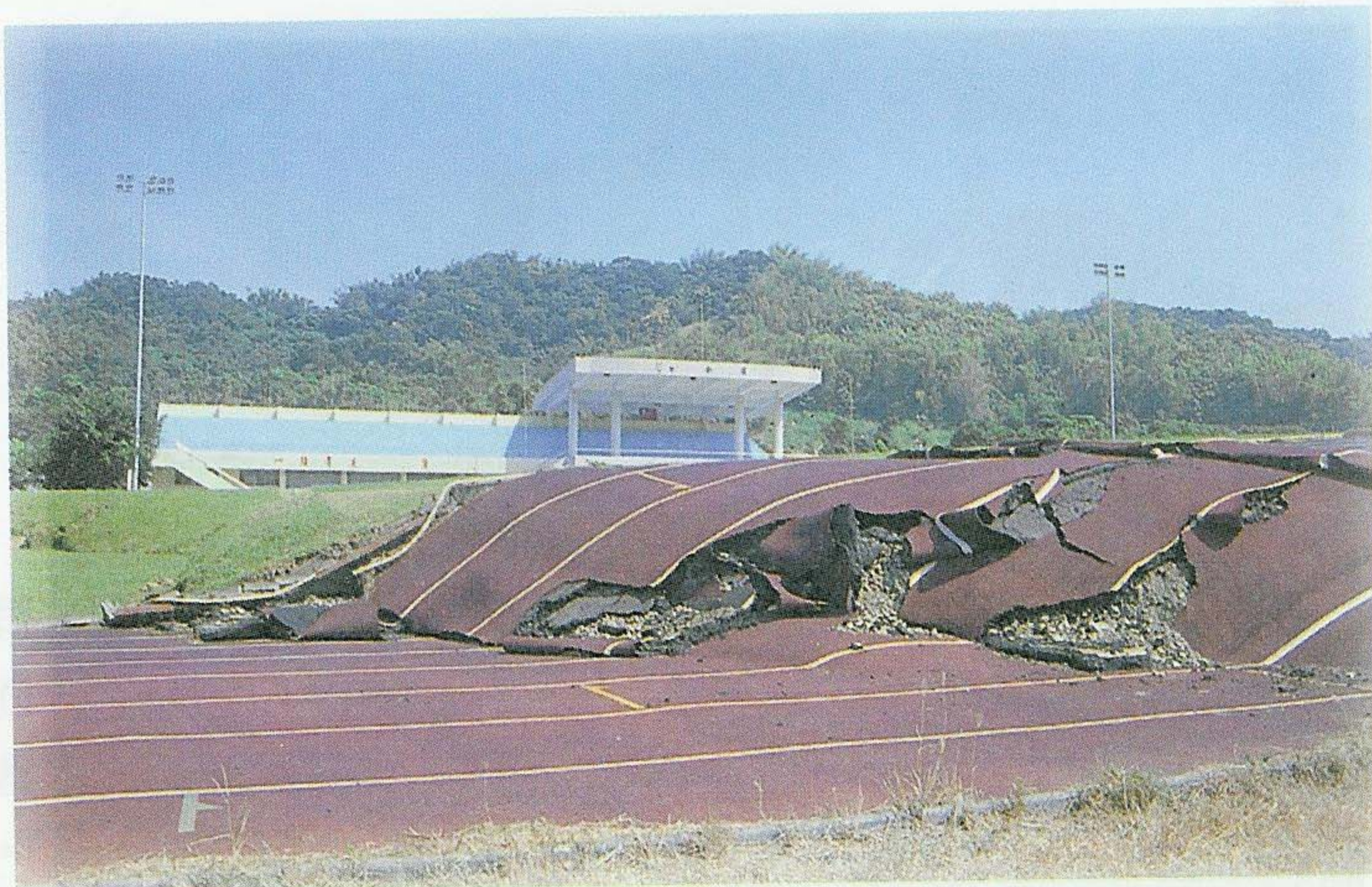
► 圖12 霧峰光復國小：斷層經過霧峰光復國小的操場，形成東側操場被抬升約2公尺。
