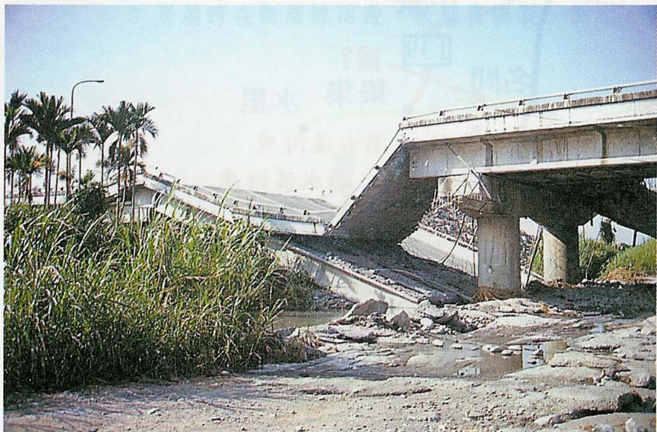
◀ 圖3 名竹大橋：名竹大橋是竹山通往名間的必經之道，斷層經過濁水溪之後繼續向南延伸，由名竹大橋南端的第二與第三橋墩之間通過，造成橋墩的傾倒與橋面的斷裂。
