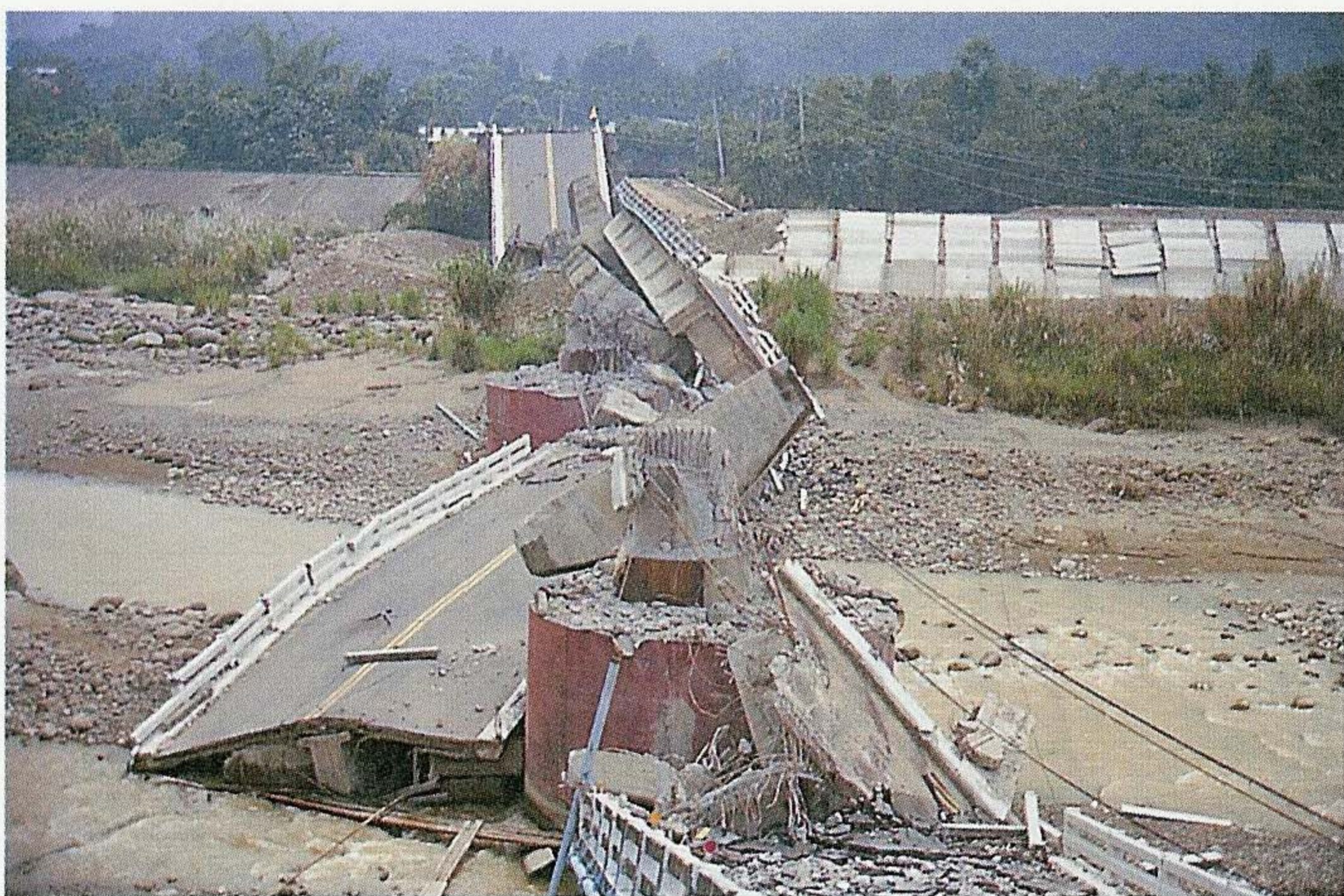
◀ 圖1 清水溪桶頭橋：桶頭橋在地震時完全被摧毀，橋墩被攔腰折斷，橋面斷落到河床。造成桶頭橋如此觸目驚心的景象是因為觸口斷層（可視為車籠埔斷層的向南延伸）橫切通過橋樑的中間，南側（遠處）地塊約被抬高0.5公尺。
