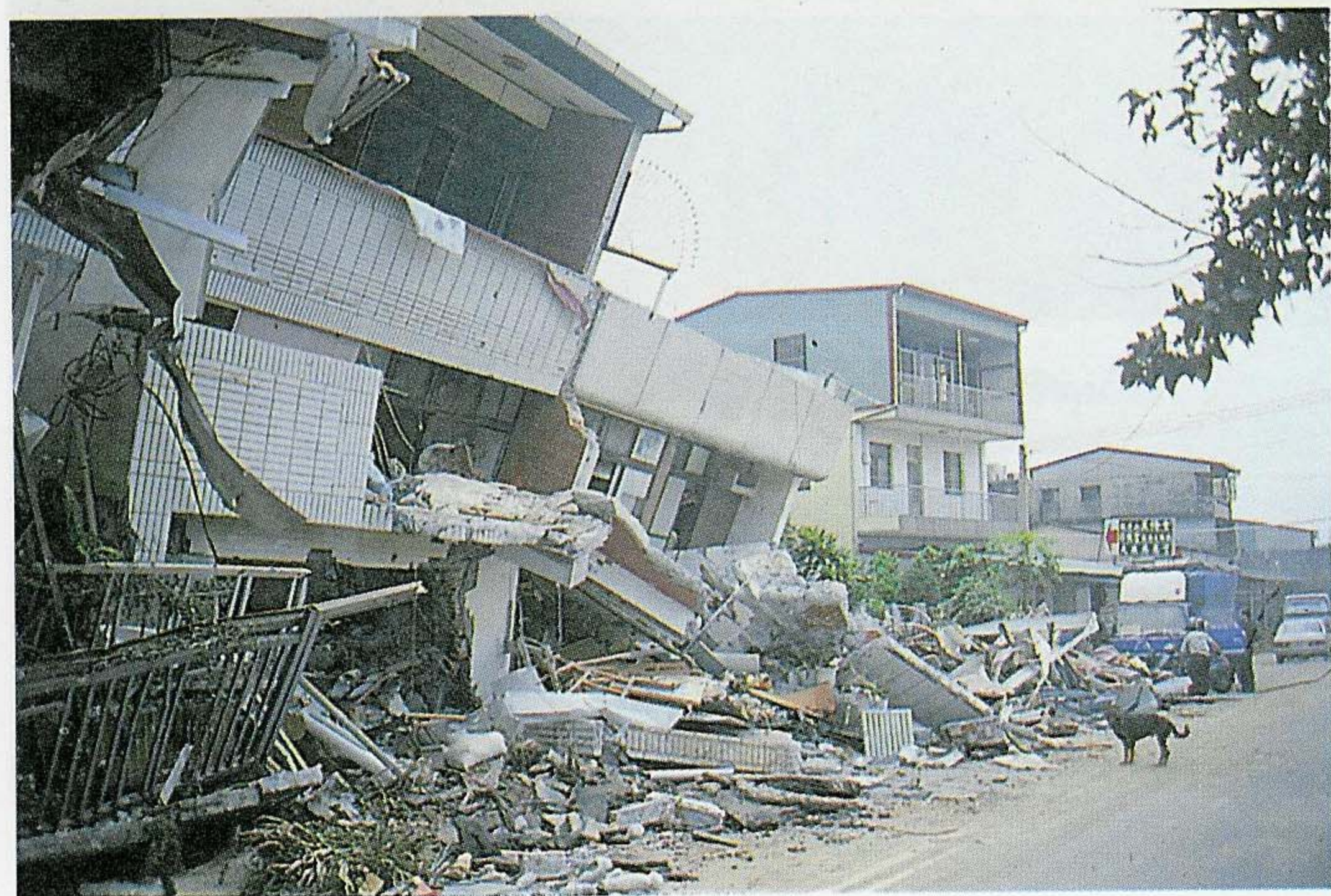
◀ 圖23 中台醫專(芋園橋)：道路左側房屋座落在斷層之上，斷層活動時將房屋的後側抬高約1.5公尺，造成房屋向前傾倒並將一樓壓毀。後側直立沒有損壞的房屋距離斷層約1公尺，因沒有位在斷層之上而僥倖逃過一劫。
