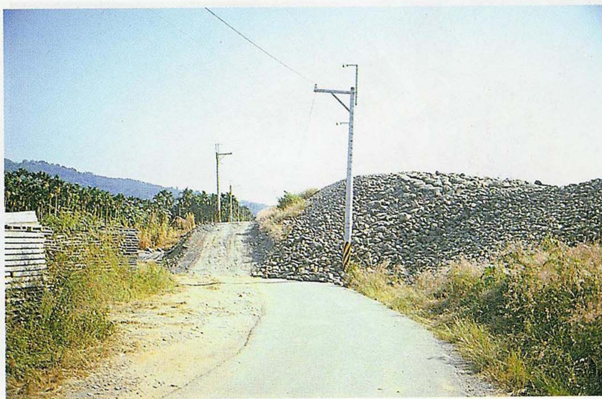
► 圖6 濁水溪河堤：斷層橫切過濁水溪的河堤，從原來平整的河堤被抬升成為高低兩個階面，河堤的東側被隆起約2公尺。同時河堤邊的道路可以清楚的看見路面被截斷，東側道路向北(或西北)位移約3.5公尺。
